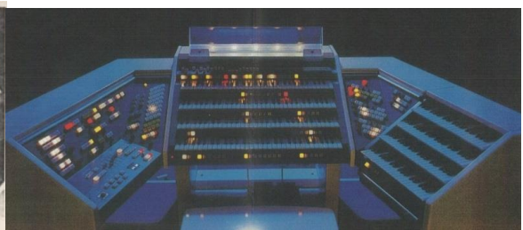
写真 11) ステージ上の T-50 パネル点灯
